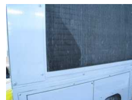
室外機の油にじみ
